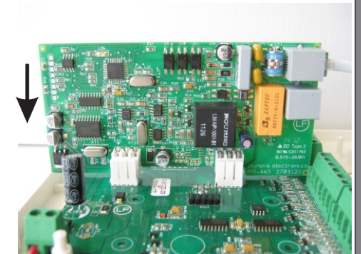
Σχήμα 2 : Τοποθέτηση BS-465 στον πίνακα BS-468
